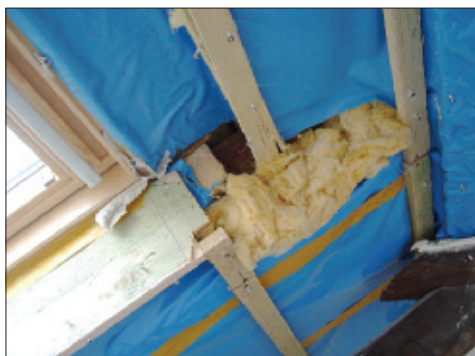
Рис. 1. Дефекты утепления и пароизоляции
