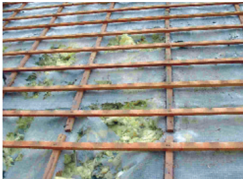
Рис. 2. Разрушение гидроизоляционной пленки
