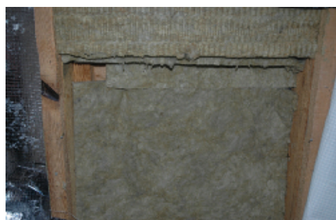
Рис. 4. Дефект утепления: три слоя изоляции уложены без сдвига стыков, полностью отсутствует утеплитель в левой части
