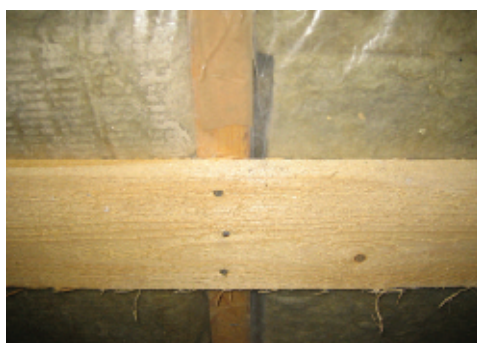
Рис. 5. Дефекты утепления: сплошные щели в изоляции на примыканиях к стропилам
