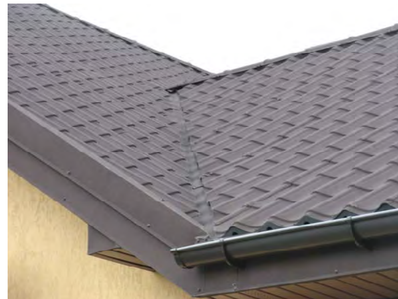
Рис. 75. Отсутствие декоративной накладки на ендове
