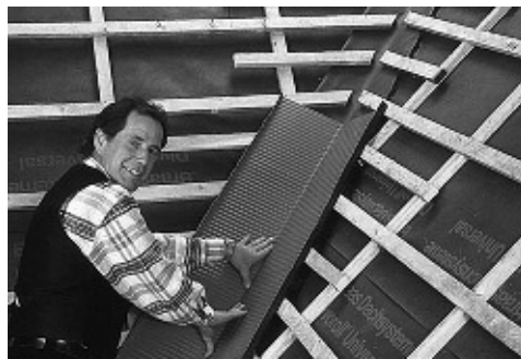
Рис. 7. Сомнительная конструкция: крепление обрешётки к настилу ендовы снижает надёжность конструкции от протечек талой воды
