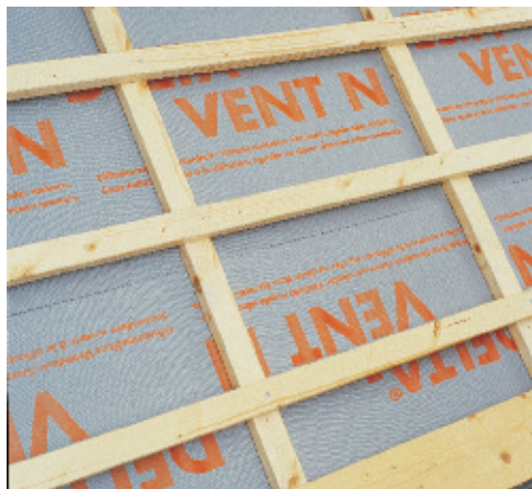
Рис. 1. Набиваемая на стропила контробрезетка может стать элементом, под который через гвоздевые отверстия затекает талая или дождевая вода. Это особенно опасно, когда уклон ската менее 20° и кровля имеет сложную форму
