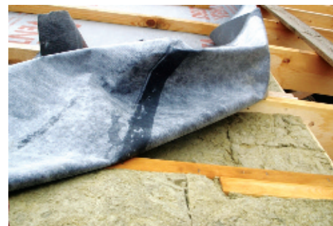
Рис. 2. Протечка дождевой воды под контробрезетку
